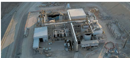
Infraestructura de la Planta de Tratamiento de Aguas Residuales Paso Limonero
