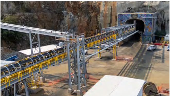
El transportador de banda del Túnel Guajes
